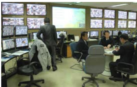
Exemple de mur vidéo
